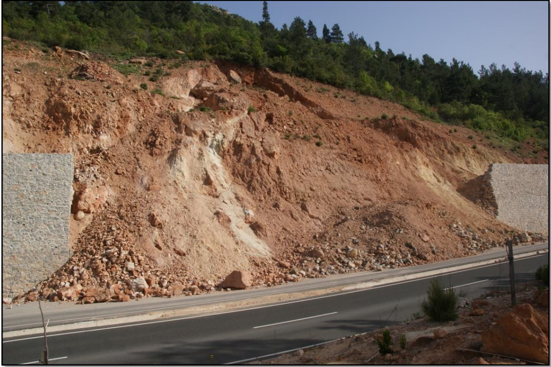
Foto 34. Yamaç Dengesinin Bozulması Sonucunda Büyük Miktarda Malzeme İstinat Duvarını Yıkarak Yola Taşmıştır. Bitki Örtüsünün Tahrip Edilmesi de Bunda Önemli Rol Oynamaktadır (Balıkesir - Edremit Karayolu 60. km, 2015).
