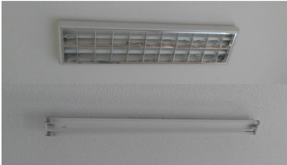
Şekil 3.13: Hastane binasında bulunan aydınlatma elemanları.
