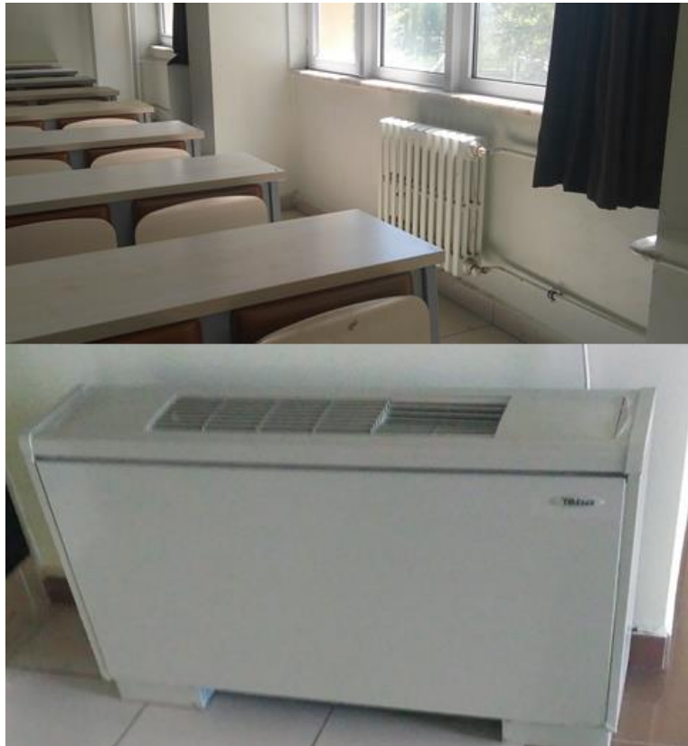
Şekil 3.14: Hastane binasında bulunan radyatör ve fancoil.
