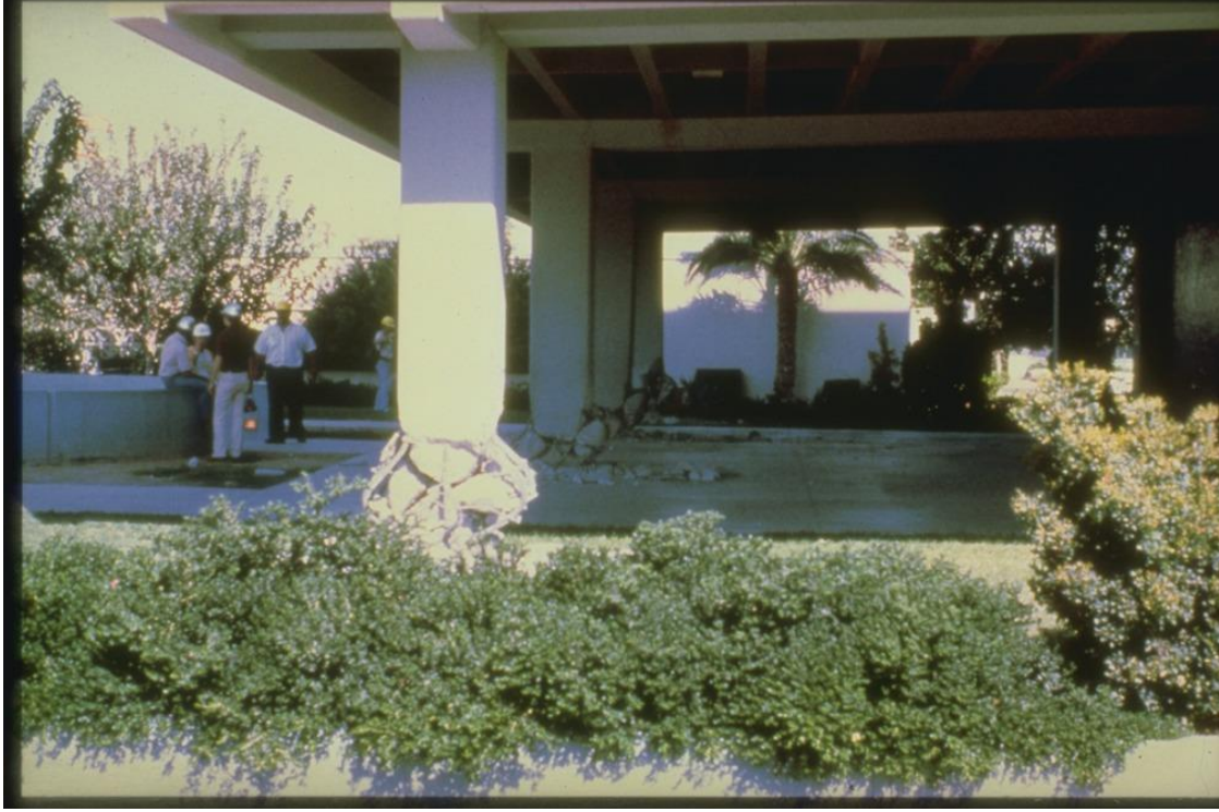
Şekil 2.2: Imperial Valley depremi sonrası düşey deprem etkisi sonucu yapı kolonlarında oluşan hasarı gösteren bir resim [9].
