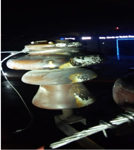
Şekil 3. Saraylar enerji nakil hattında kuru band yüzünden kısmi deşarja neden olan izolatör (Insulator causing partial discharge as a result of a dry band at Saraylar distribution system)
