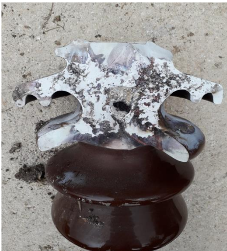
Şekil 4. Gündoğdu enerji nakil hattında kısmi deşarja neden olan izolatör (Insulator causing partial discharge at Gündoğdu distribution system)
