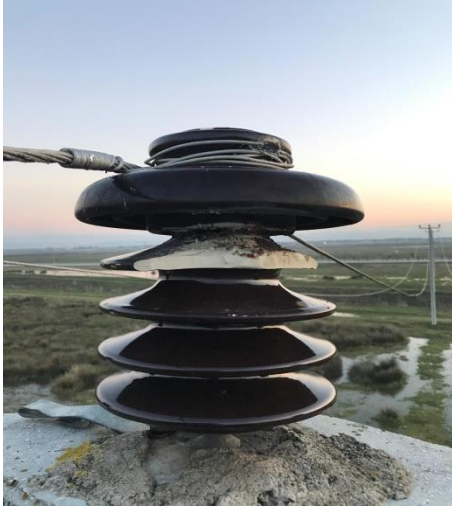
Şekil 1. Musakça enerji nakil hattında yüzeysel kısmi deşarja neden olan izolatör (Insulator causing surface partial discharge at Musakça distribution system)
