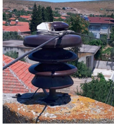
Şekil 2. Çınarlı enerji nakil hattında kısmi deşarja neden olan izolatör (Insulator causing partial discharge at Çınarlı distribution system)
