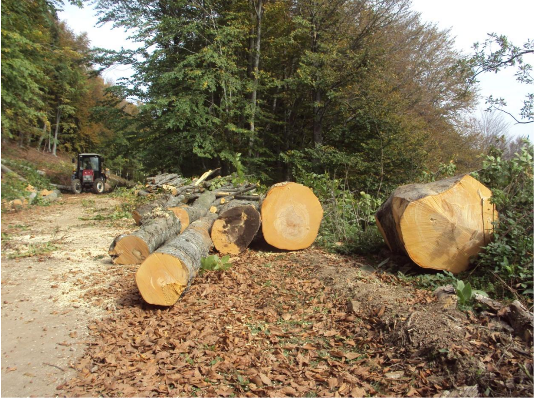
Şekil 9. Rüzgâr Enerji Santrallerinin Tesisler İçin Ulaşım Yollarının Düzenlenmesi Sırasında Kayın Ormanlarının Tahrip Edilmesinden Bir Görünüm.
