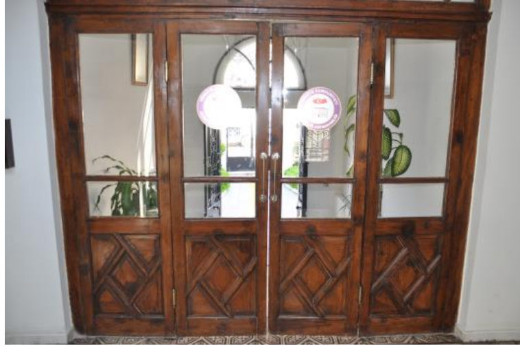
Şekil 4.68: Altieylül Kaymakamlığı binası özgün kapı detayı (S. Yırcalı arşivi, 2019).
