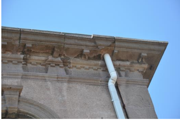
Şekil 4.18: Güzel Sanatlar Fakültesi yeniden kullanım sorunları (S. Yırcalı arşivi).
