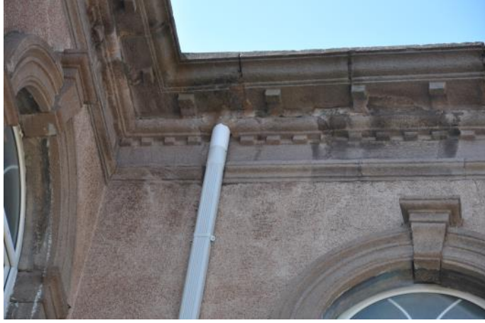
Şekil 4.17: Güzel Sanatlar Fakültesi yeniden kullanım sorunları (S. Yırcalı arşivi).
