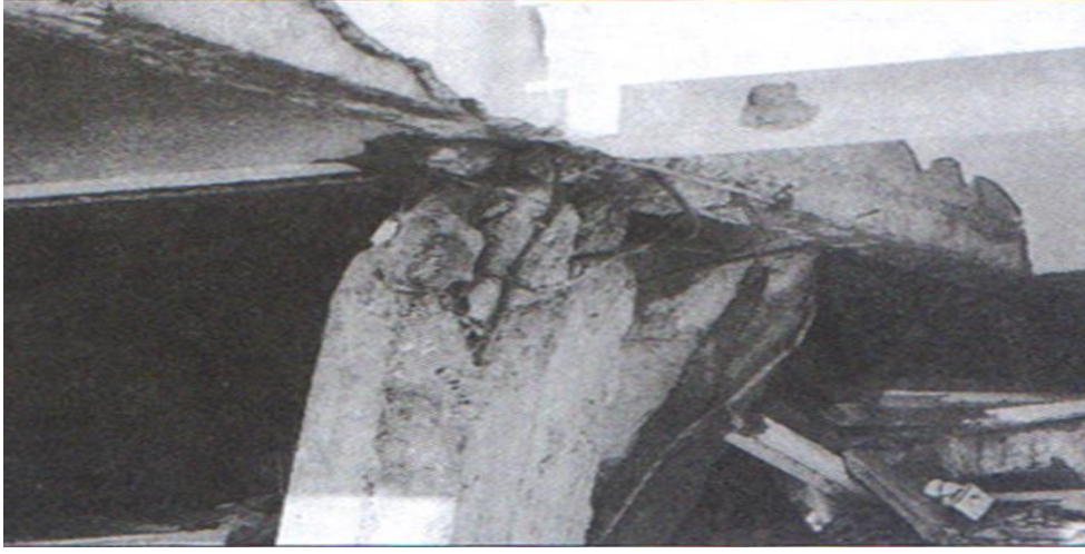
Şekil 6.5: Kolon kiriş birleşim bölgesinde eğilme momentini taşıyamayan kolon.
