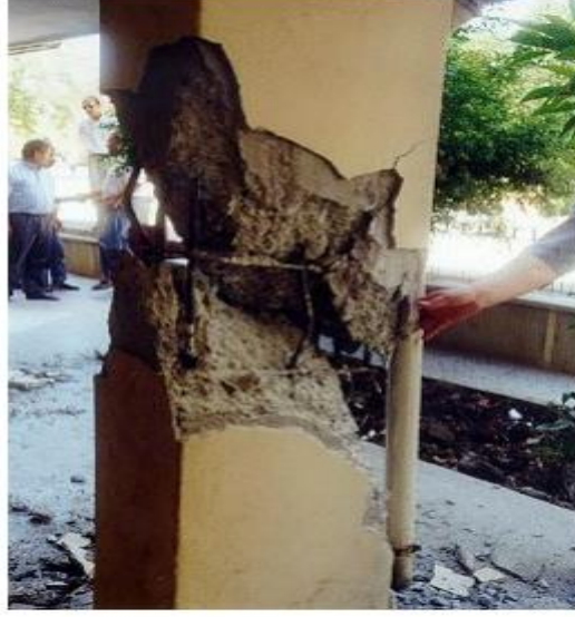
Şekil 6.7: Kesme kırılması örneği (etriye sıklaştırması yapılmamış).
